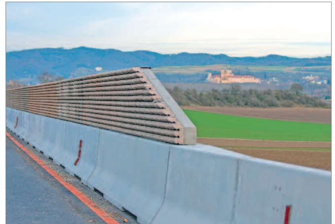
Bild 31: Leitwandsystem mit kombinierter Lärmschutzwand
