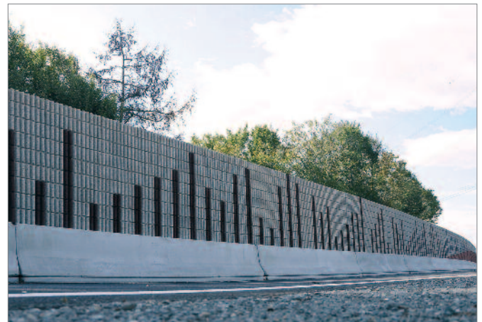
Bild 32: Leitwandsystem mit kombinierter Lärmschutzwand
