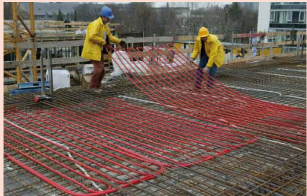
Abbildung 39: Verlegung der Rohrträgermatten einer Bauteilaktivierung (Quelle: Vereinigung der Österreichischen Zementindustrie, Expertenforum Beton, Heizen + Kühlen mit Beton; Foto: Rehau AG).
