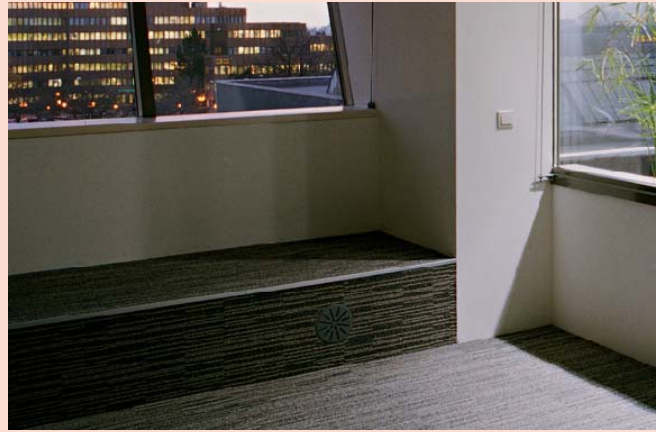
Abbildung 24: Luftauslass für die Quelllüftung im ENERGYbase, Wien. (Foto: Hertha. Hurnaus, Architektur: pos architekten).
