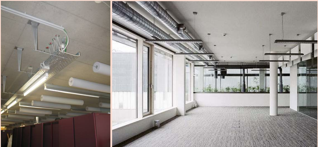
Abbildung 18: Sichtbetondecke mit oberflächlicher Verlegung der Beleuchtung, der Lüftungskanäle Rauchmelder sowie Akustik-Baffles. Links: Neubau Donau Universität Krems (Foto: Peter Holzer), Rechts: ENERGYbase, Wien (Foto: Hertha Hurnaus, Architektur: pos architekten).
