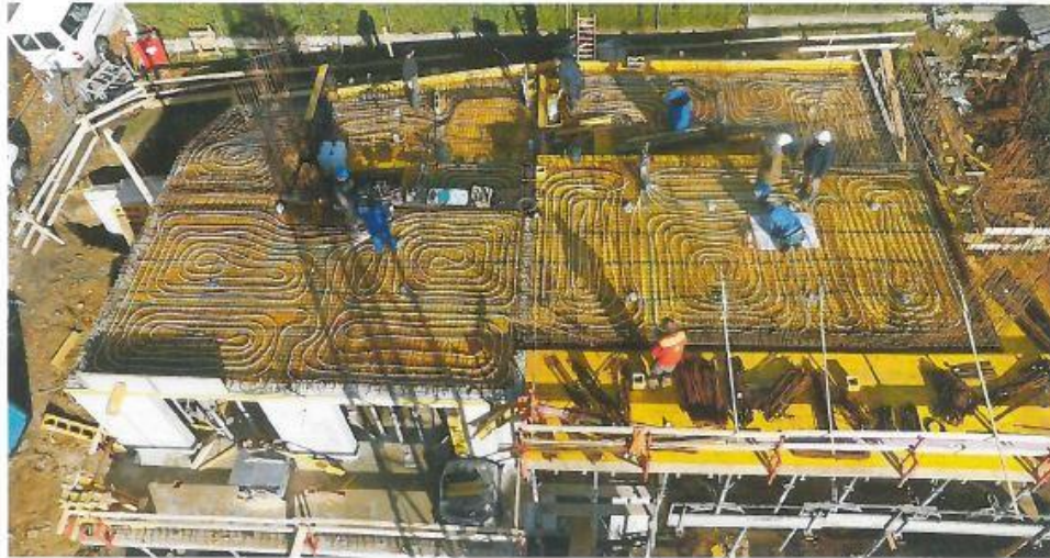
AKTIV Die Schläuche in den Decken wurden kreisförmig aufgelegt und das System wurde unterteilt, wodurch jeder Raum einzeln ansteuerbar ist.
