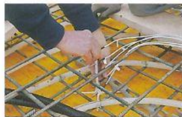
ALLES IM BLICK Die bauteilaktivierten Decken wurden allesamt mit Sensoren ausgestattet, um eine individuelle Anpassung zu ermöglichen und dadurch auf Wünsche der Bewohner reagieren zu können.
