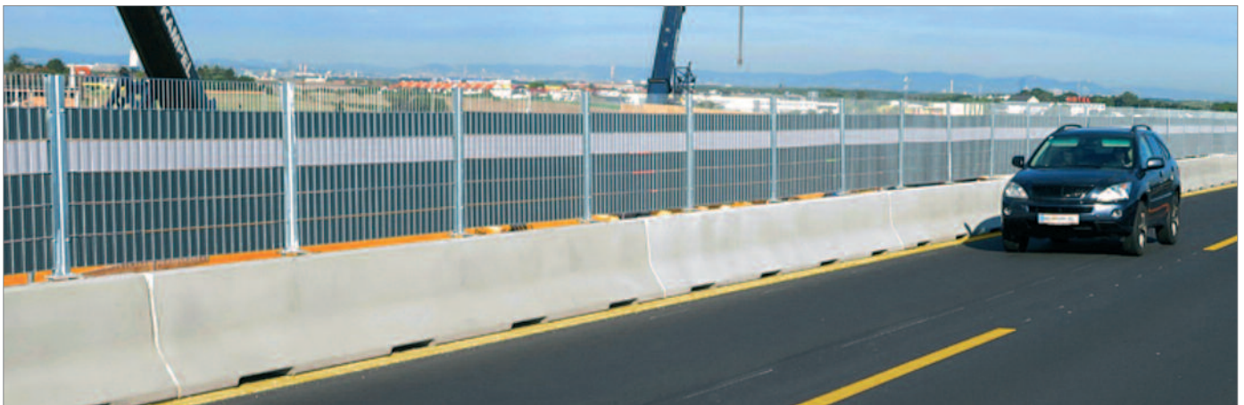
Bild 35: Leitwandsystem mit kombiniertem Sicht-, Blend- und Spritzschutz
