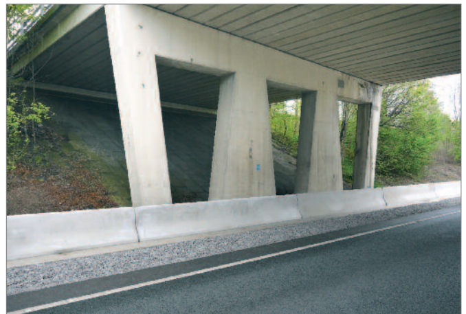
Bild 7: Hindernisabsicherung mit eingebettetem System
