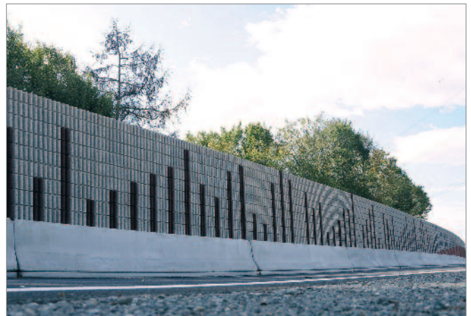
Bild 32: Leitwandsystem mit kombinierter Lärmschutzwand
